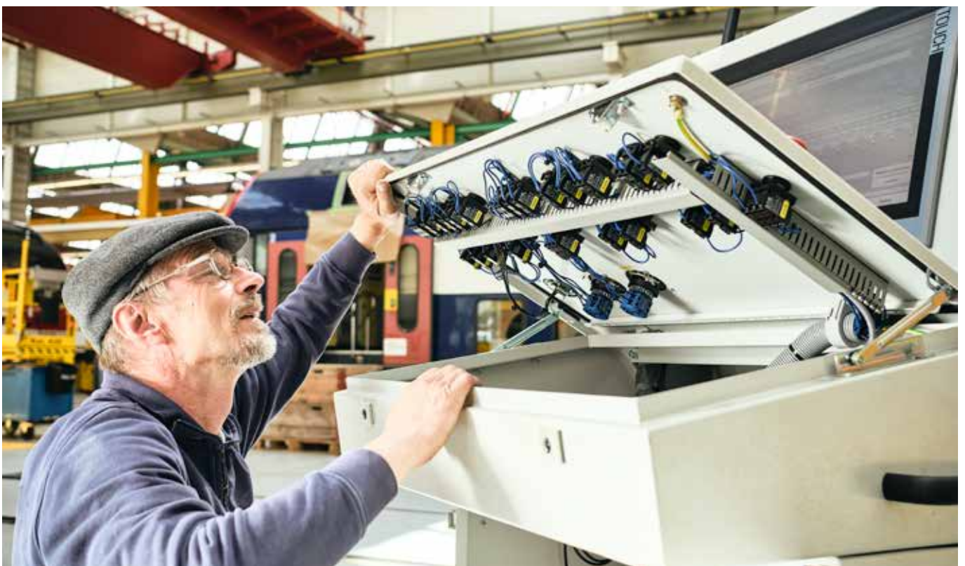
Sichtkontrolle eines Steuerpultes einer Hebeanlage
